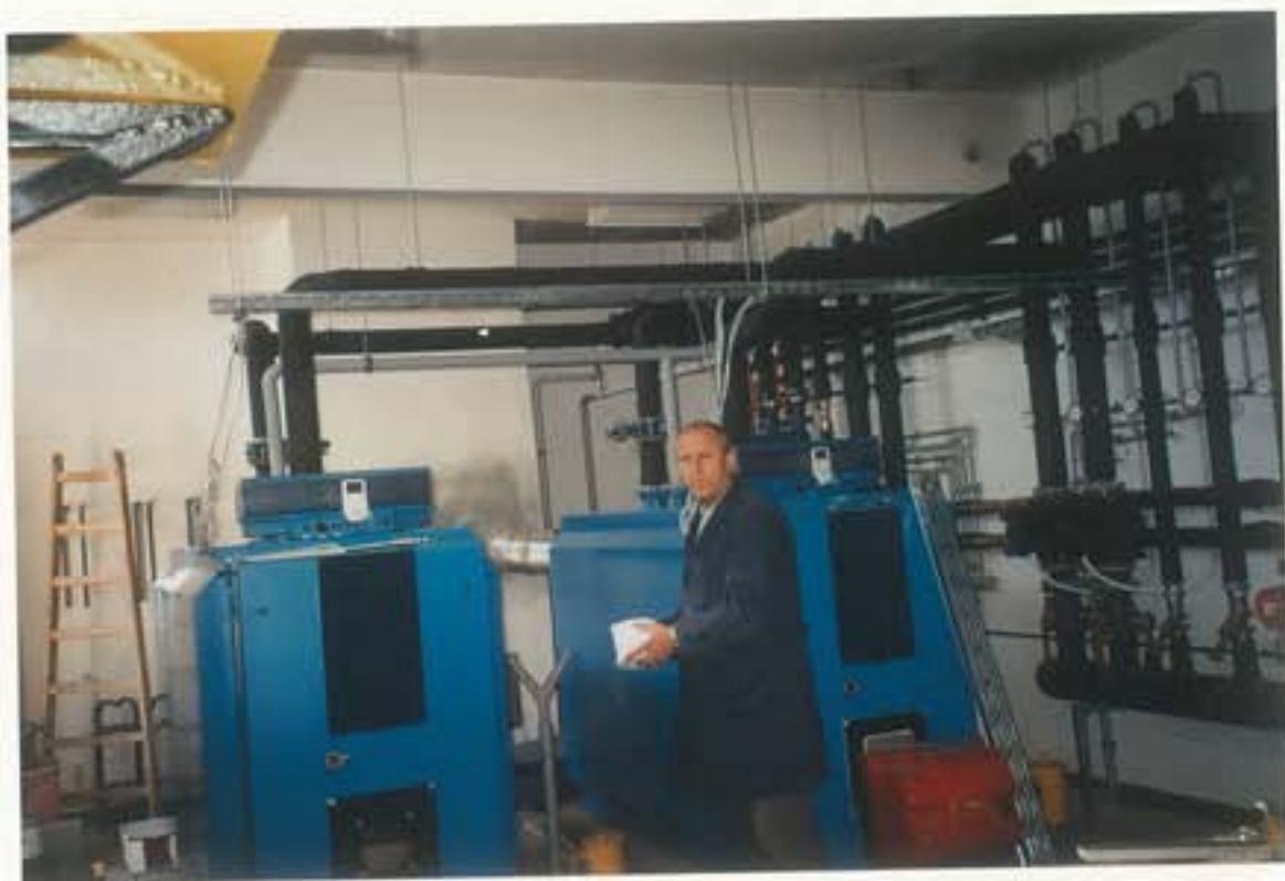
U kotlovnici su sada novi kotlovi
